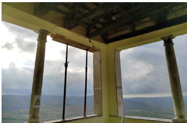
La loggia di Montona in grave stato di degrado
